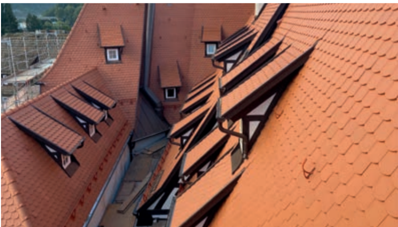
Vorher wie nachher echt steil. In das bis zu 67° geneigte Dach mit einer Fläche von 950 m 2 brachten die 38 Gauben wertvolles Licht und die Möglichkeit zum Luftaustausch.
